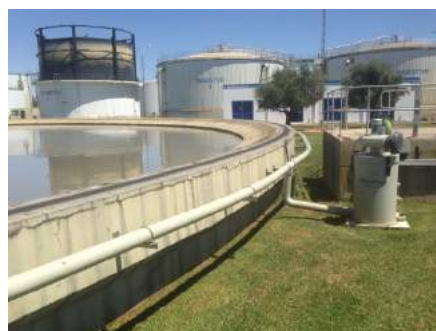
Fig 3: ejemplo de cubrición de los canales de un decantador
