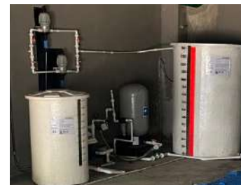
Sistema de Dosificación automáticos
