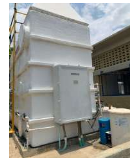
Lavador de Gases Con Biotecnologías
