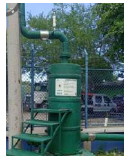
Sistema de filtración de Carbón activo
