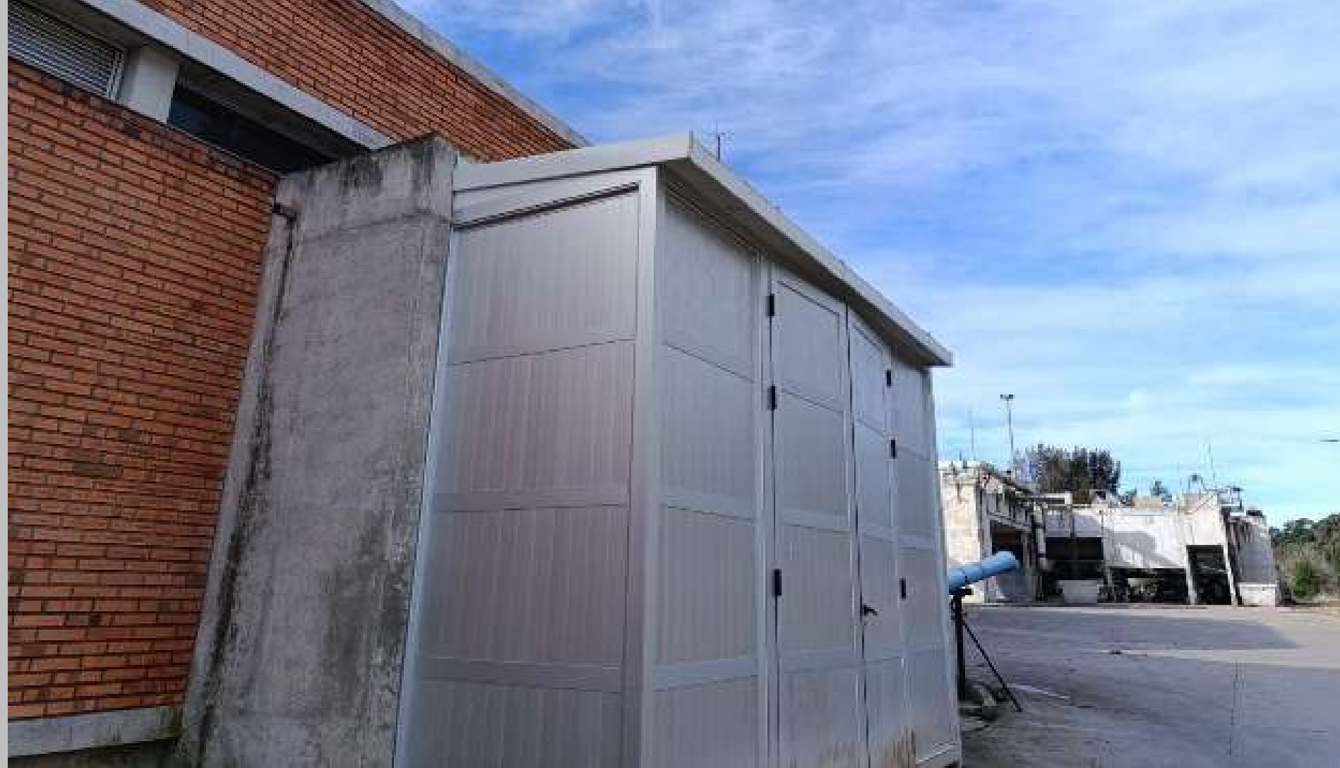
Sala de Centrífugas
