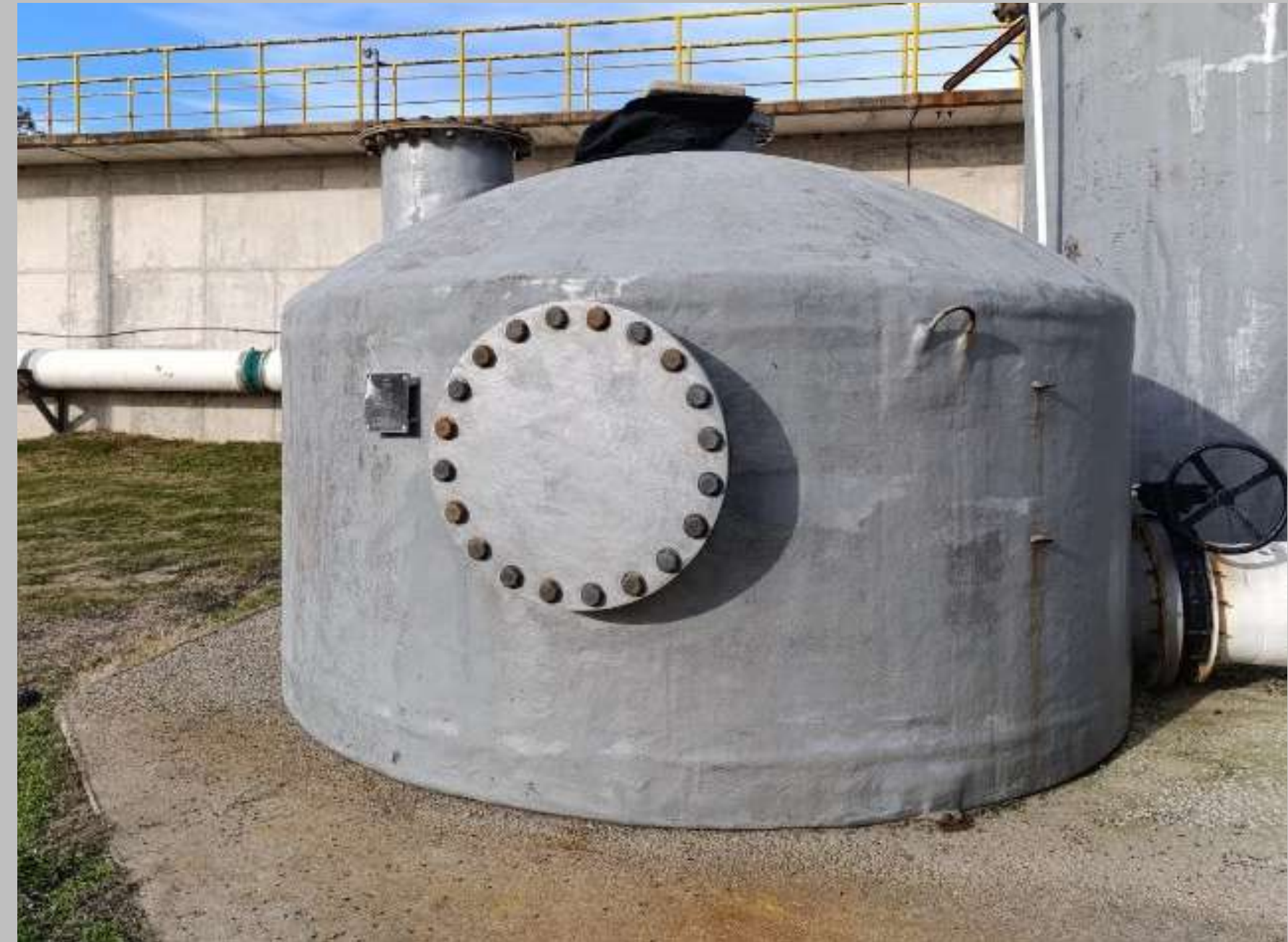
Filtro GAC Este
